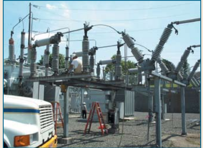
El Circuit-Switcher Mark V antes del reemplazo
