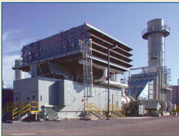
Planta “correctora” de generación con turbinas de gas de 40 MW
