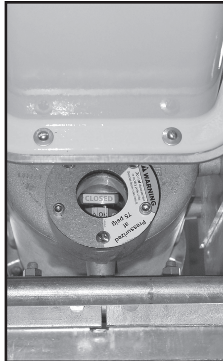
Indicadores totalmente viables debajo de un polo con moto-operador instalado.
