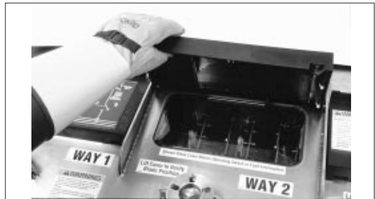
Figura 13. Cubierta de la ventana levantada para observar la posición de desconexión de las cuchillas del seccionador de carga o de los interruptores de falla.
