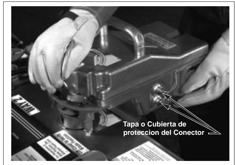
Figura 16. Retirando el moto-operador portátil del seccionador.
